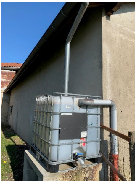
Récupérateur d'eau de pluie de 1 000 litres sur un bâtiment communal
