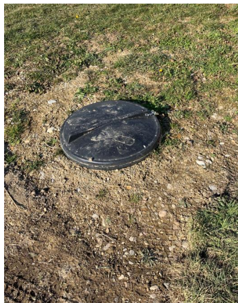
Accès au récupérateur d'eau de pluie de 5 000 litres enterré près du stade
